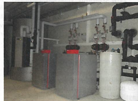
Zwei Wärmepumpen, Pufferspeicher und Pumpen, der Eisspeicher selbst ist vergraben
